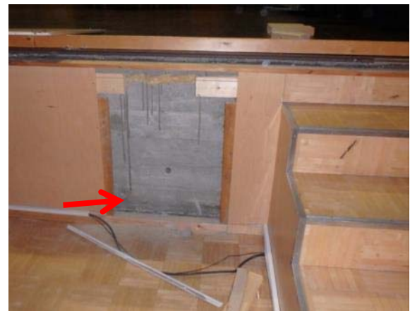
Kuva 34. Seinän rakenneavaus MV4. Betoniseinän alaosa ja sen taustalla oleva hiekka ovat märkiä.
