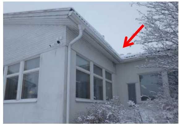
Kuva 56. Kattovuoto kohta, vuoto kohta näkyy ruokalan sisäkatossa.
