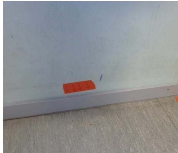
Kuva 10. Alapohjan täyttökerroksista todettiin ilmavuotoja väliseinän kohdalta, kuntosalii.
