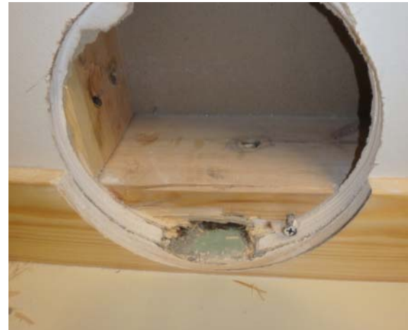
Kuva 68. Väliseinän rakenneavaus VS3, alajuoksu ja sen alapuolinen huopa on mikrobivaurioitunut.
