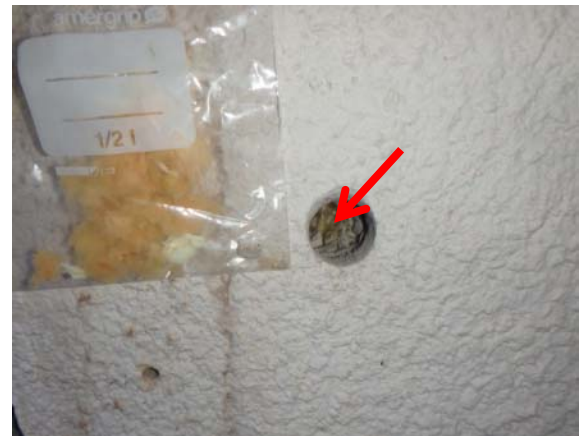
Kuva 50. Seinässä on tilkkeenä mineraalivillaa, näyte 19.
