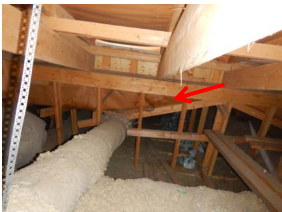
Kuva 79. Vesikaton rakenteissa ja aluskatteessa on vuotojälkiä.
