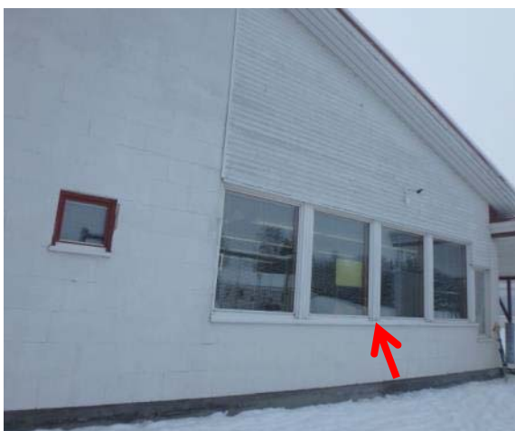
Kuva 57. Luukkasiiven ikkunavälien puuverhouksessa on lahovaurioita.
