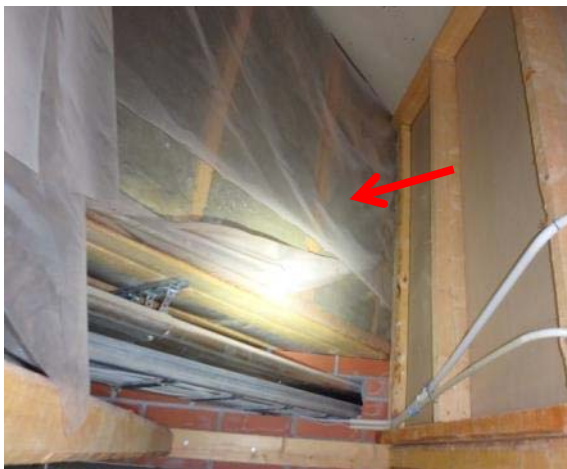
Kuva 73. Höyrynsulkumuovien tiiveydessä on puutteita.
