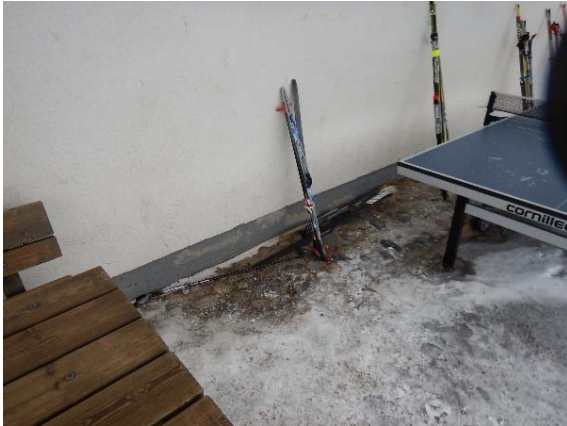
Kuva 3. Sokkelissa maalipinnan kulumaa
