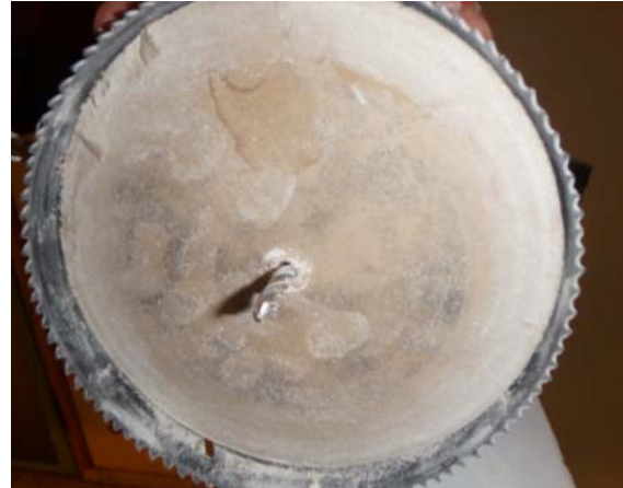
Kuva 76. Kipsilevyssä on kosteusjälkiä ja mustaa kasvustoa.
