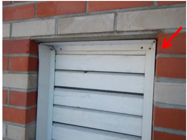
Kuva 62. Luukun pellitys ja rakenne ei ole tiivis.
