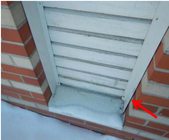
Kuva 61. Luukun pellitys ei ole tiivis.
