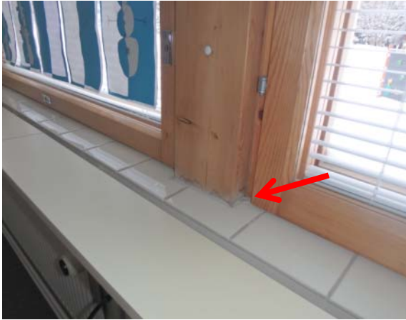
Kuva 59. Ikkunaväleissä on paikoin kosteusjälkiä.
