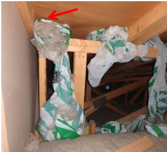
Kuva 77. Ruokalan kohdan vuotokohta yläpohjasta.
