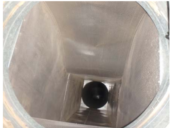
Kuva 90. Ilmavaihtokanavat ovat likaisia.
