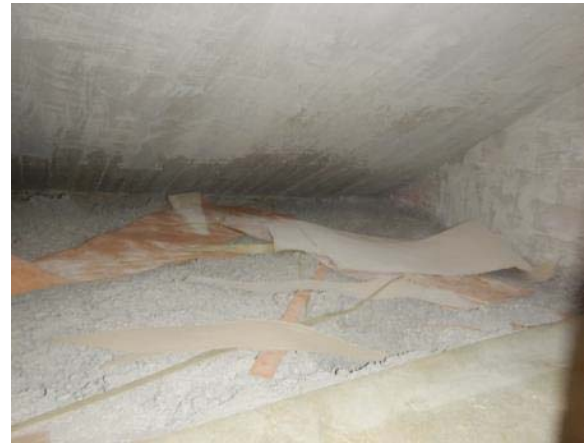
Kuva 82. Lipunmyynnin tilassa portaan alla on rakennusjätettä, PRS1.
