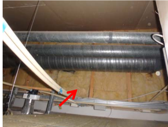
Kuva 84. Alaslaskuissa on paljaita ulkoseinien mineraalivillaeristeitä.
