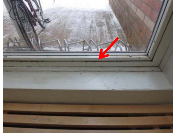
Kuva 60. Ikkunassa on ruostetta ja ikkunapenkillä kosteusjälkiä.
