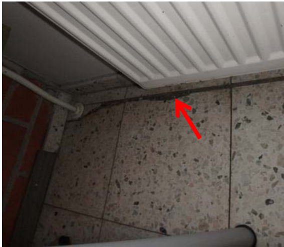
Kuva 9. Alapohjassa on runsaasti halkeamia.
