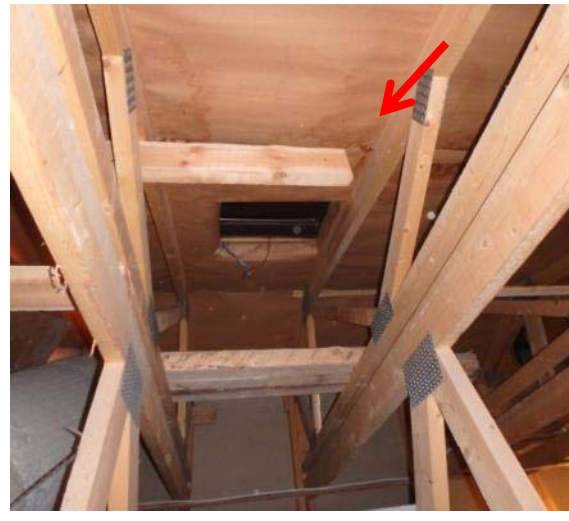
Kuva 78. Vesikaton rakenteissa ja aluskatteessa on vuotojälkiä.
