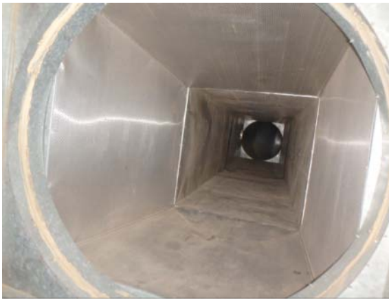
Kuva 89. Ilmavaihtokanavat ovat likaisia.
