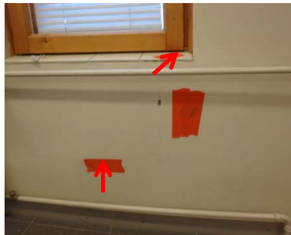
Kuva 64. Ulkoseinästä on runsaasti ilmavuotokohtia.
